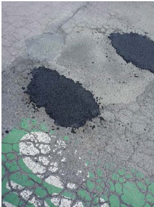
Réparations de nids de poules sur la route de Traisnel et rue du Prétolu.
